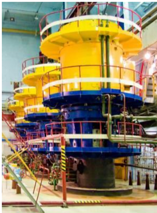
Фото 3. Главные циркуляционные насосы Смоленской АЭС
