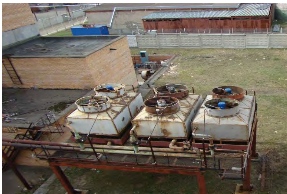
Градирни оборотного водоснабжения системы охлаждения печей выращивания слитков кремния
