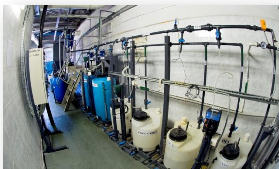
Рисунок 20. Установка обезвреживания слабощелочных стоков
