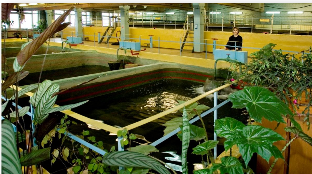
Рисунок 19. Станция фильтрации и водоподготовки
