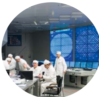
Блочный щит управления
