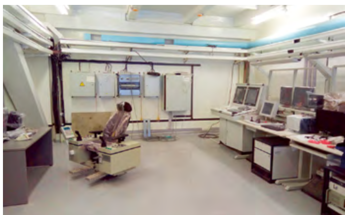
ХТРО-III. Помещение АСУ ТП и операционный зал
