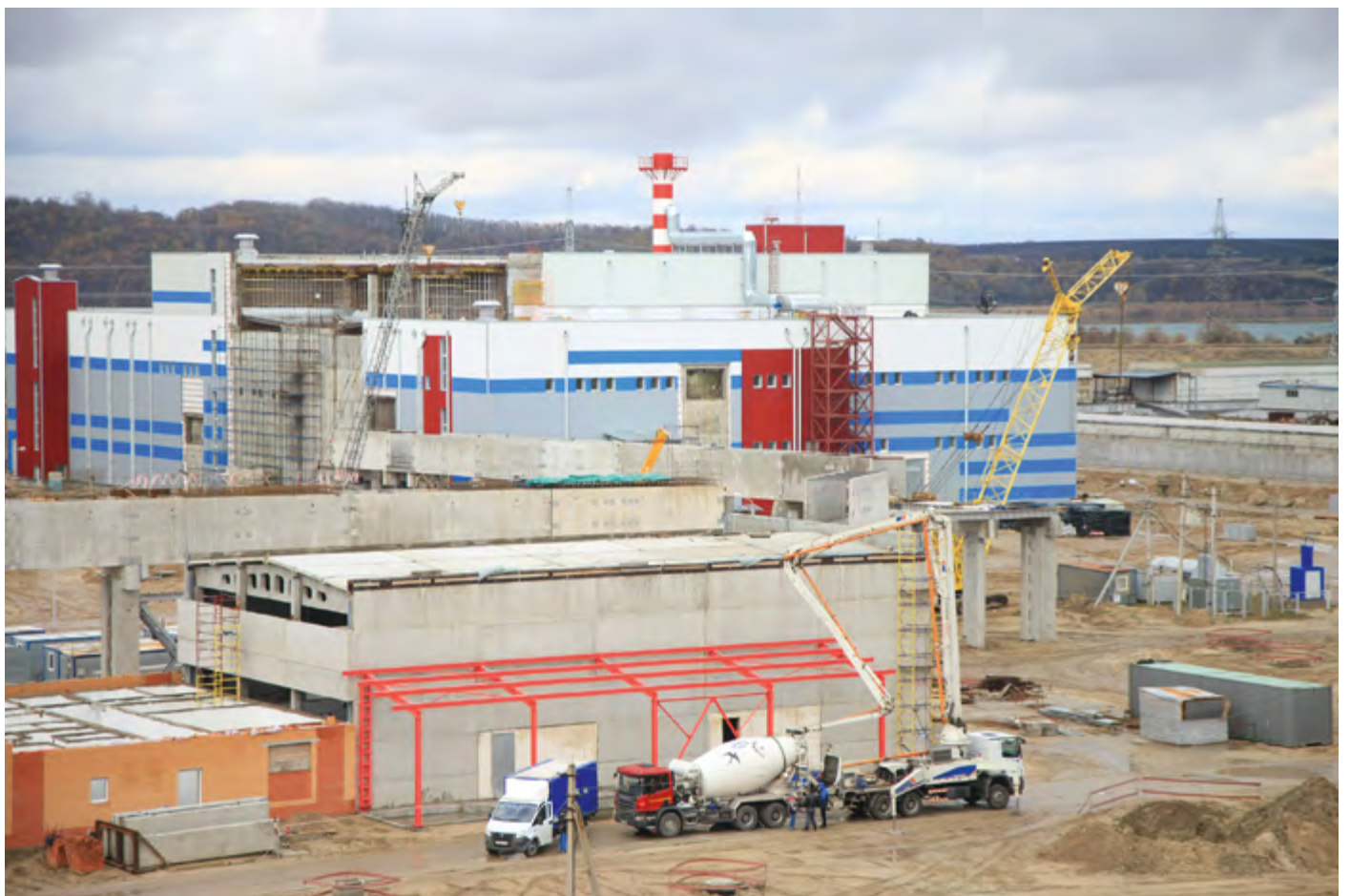
Комплекс по переработке твердых радиоактивных отходов (склад едкого натра)
