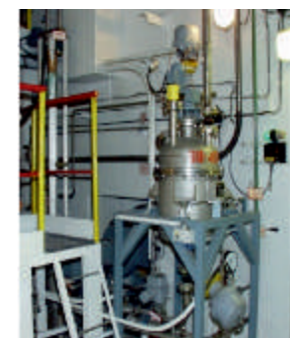
Узел системы переработки трапных вод
