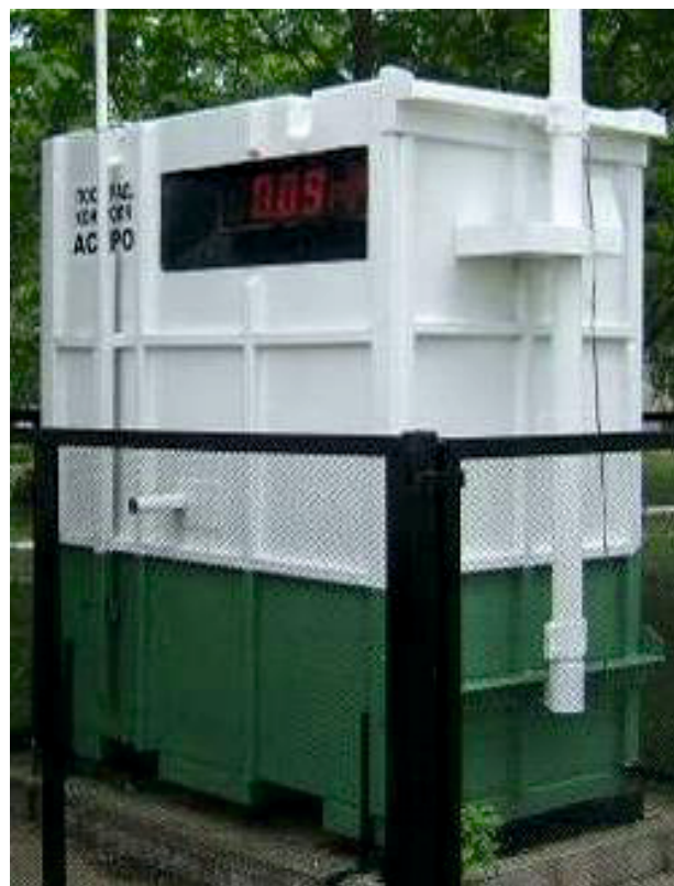
Фото 10. Наблюдательный пост автоматизированной системы контроля радиационной обстановки (АСКРО) в зоне наблюдения Смоленской АЭС
